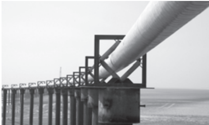
Die vorgefertigten Seepipelines wurden über die gesamte Offshore-Distanz von 7,5 km Länge in sechs Abschnitten in vorbereitete Horizontalbohrungen eingezogen. Hierfür wurden Pfähle mit Rollenlagern errichtet, auf der sich die Rohrstränge transportieren ließen.
